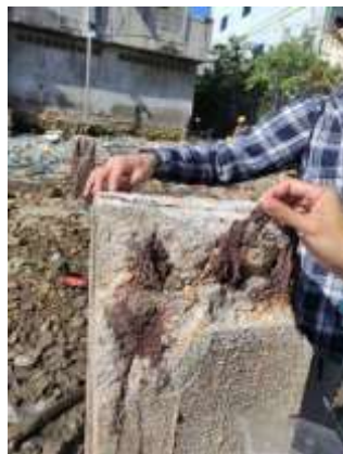
Gambar 7. Proses Pengambilan Sampel Lapisan Karat Pada Tulangan Pondasi (Sumber: Penulis, 2023)
