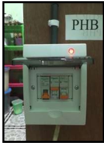
Gambar 9. Kondisi RCBO setelah terjadi hubung singkat pada beban
