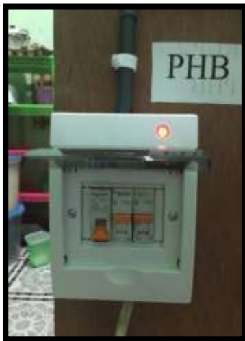
Gambar 12. Kondisi RCBO setelah bagian fasa stop kontak dihubungkan ke tanah
