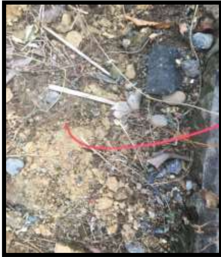
Gambar 11. Kabel yang menghubungkan bagian fasa dari stop kontak dengan tanah
