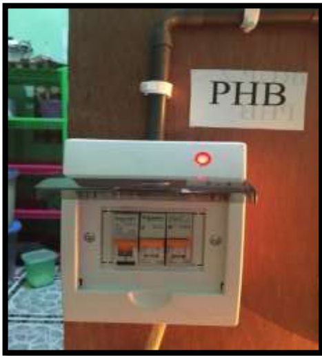
Gambar 4. Visual dari RCBO dan MCB pada panel hubung bagi untuk kondisi normal tidak ada gangguan
