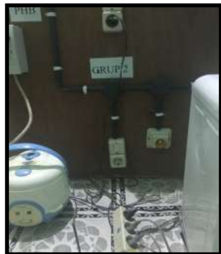
Gambar 6. Pembebanan rangkaian instalasi RCBO dengan berbagai peralatan listrik
