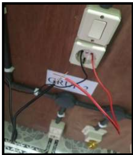
Gambar 8. Hubung singkat antara bagian fasa dengan netral pada salah satu group pembebanan
